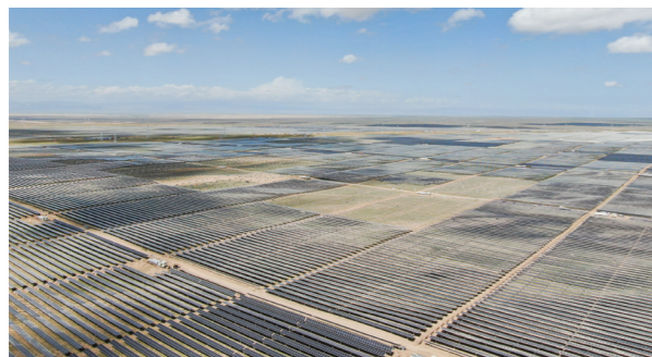
图4: 黄河水电青海特高压电站135MW项目
